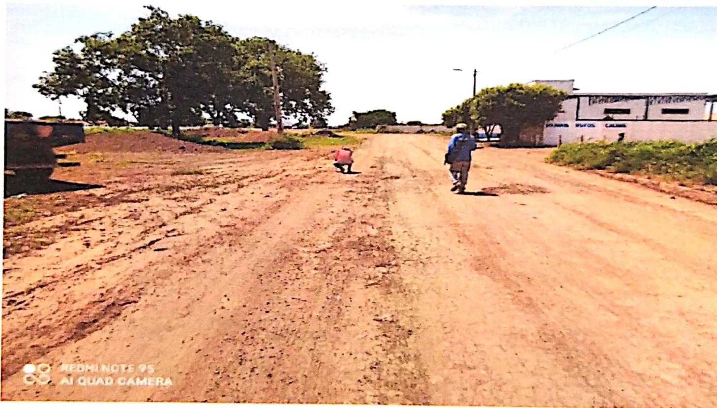
(Avenida Federal da rua 13 até a Parque de exposição agropecuária) FONTE: CONSTRUBASE ENGENHARIA
